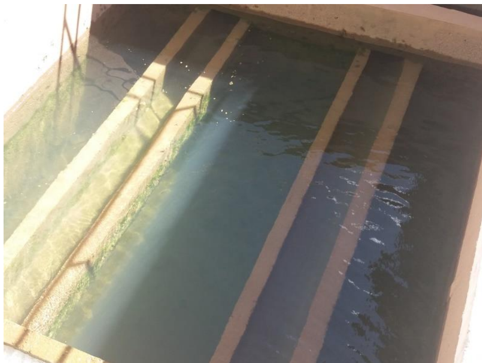
Figura 4-26 – Filtro na ETA Rio Verde Fonte: Projeta Engenharia (2017)
