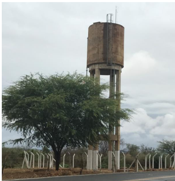
Figura 4-50 – Reservatório de água tratada (Embasa) – Prevenido
