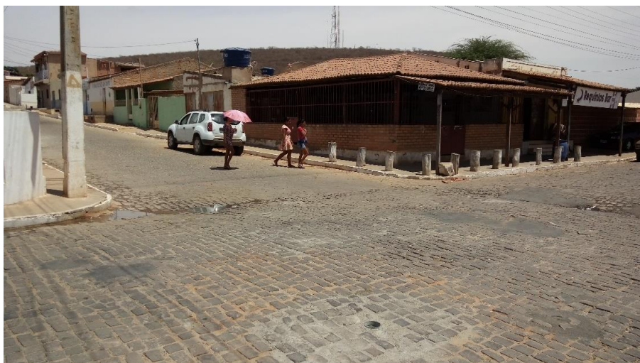
Figura 4-172 – Ausência de dispositivos de microdrenagem – Avenida Nestor Borges (próximo do Requintes Bar) - Sede
