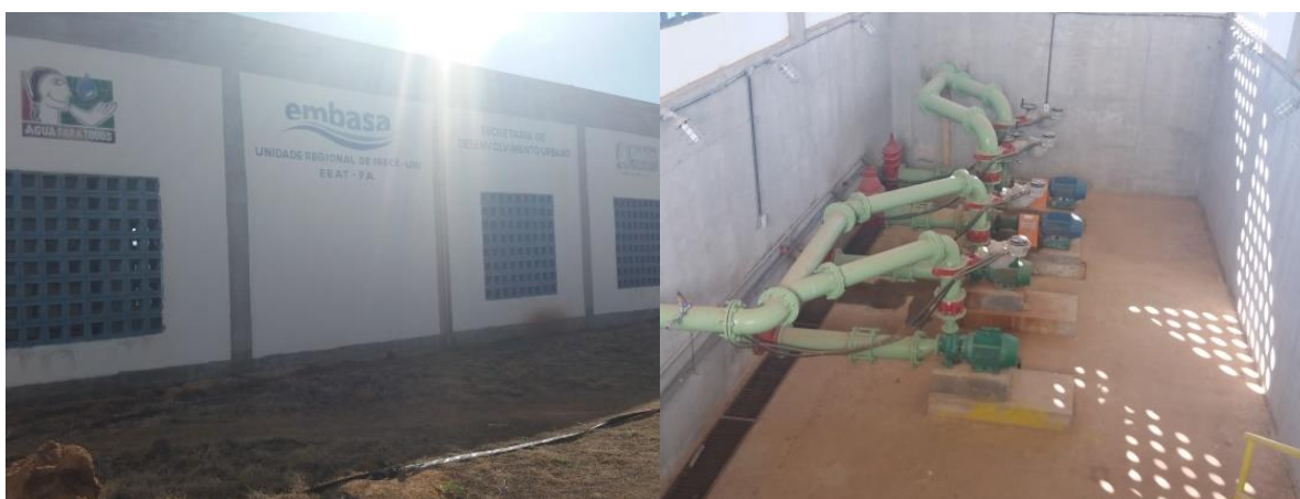
Figura 4-33 – Estação Elevatória de Água Tratada 9A e conjuntos moto-bomba
