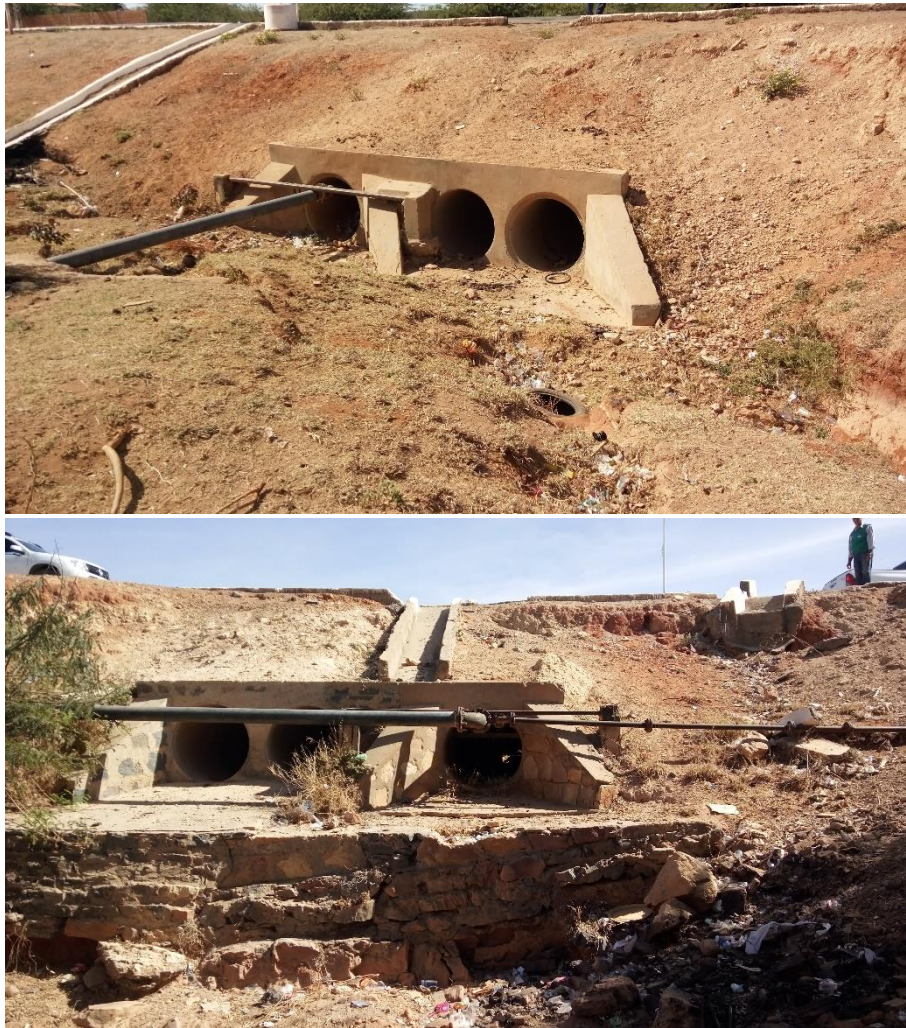
Figura 4-163 – Bueiros para passagem de água na rodovia BA-052 – Lançamento no curso d’água intermitente (sem nome) - Sede Fonte: Projeta Engenharia (2017)
