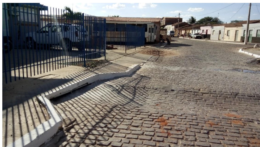
Figura 4-198 – Ponto 13 – Rua da Lagoa I - Soares Fonte: Projeta Engenharia (2017)
