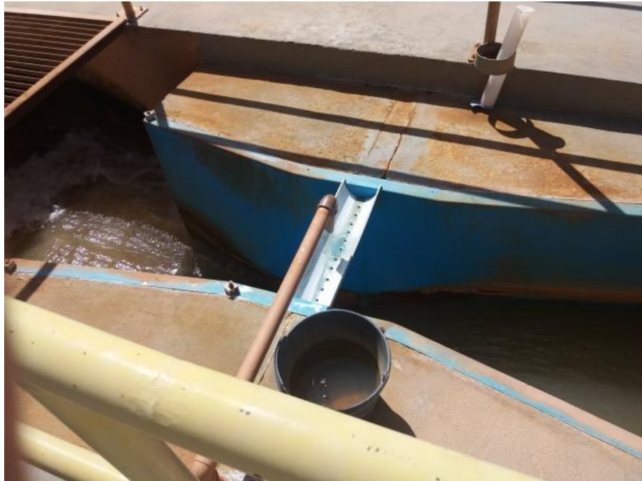
Figura 4-22 – Dosador de coagulante na calha parshall na ETA Rio Verde Fonte: Projeta Engenharia (2017)
