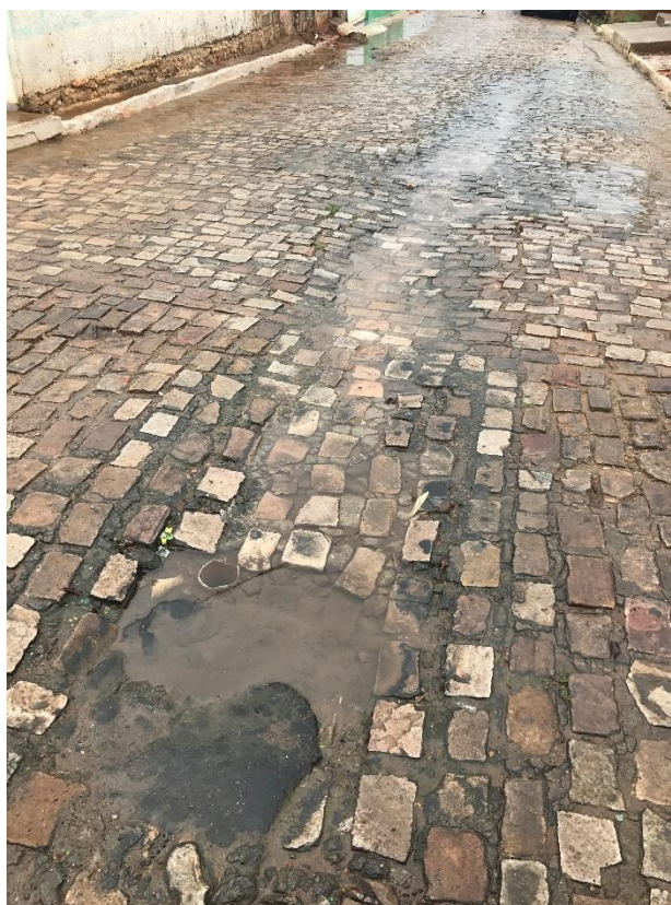
Figura 4-42 – Vazamento na tubulação água potável
