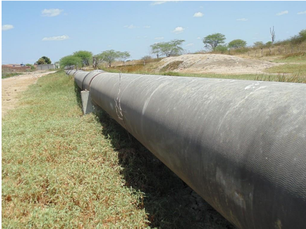
Figura 4-13– Adutora água Bruta – Irecê
