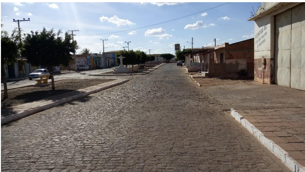
Figura 4-170 – Ausência de dispositivos de microdrenagem – Avenida Irecê - Soares Fonte: Projeta Engenharia (2017)
