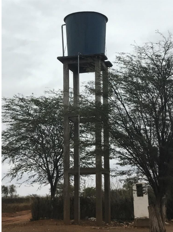
Figura 4-72 – Reservatório de água tratada salobra – Ipanema
