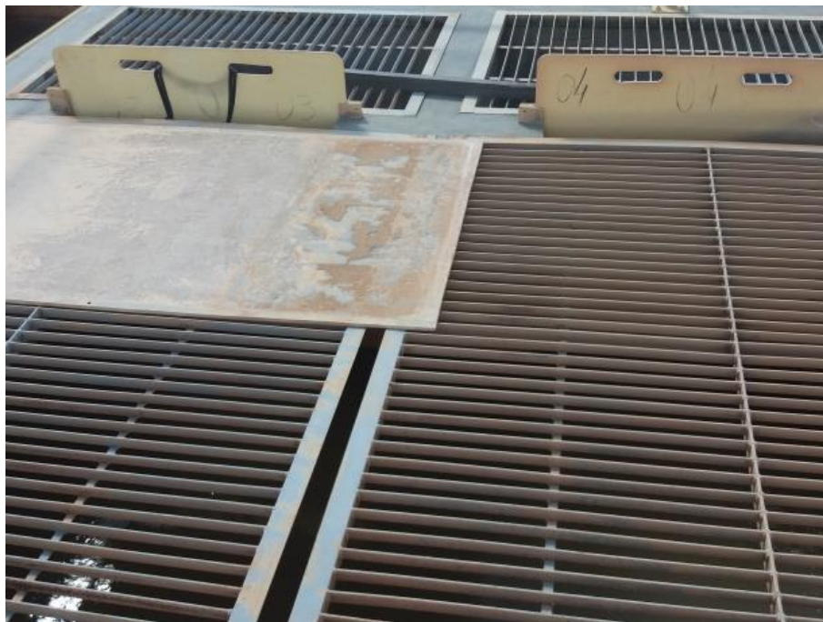
Figura 4-23 – Caixas de distribuição para coagulação na ETA Rio Verde Fonte: Projeta Engenharia (2017)
