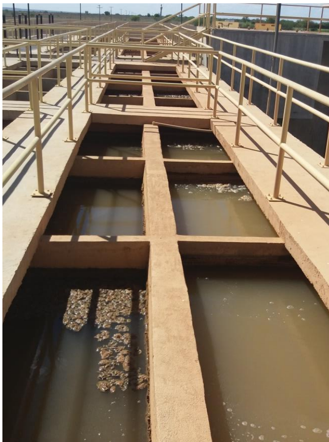
Figura 4-24 – Câmaras de floculação na ETA Rio Verde
