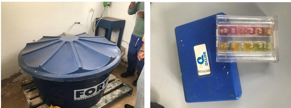
Figura 4-59 – Cloração e medição de pH de água salobra - Soares
