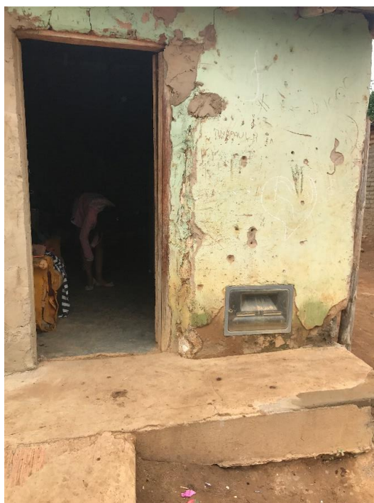
Figura 4-74 – Residência com rede de água hidrometrada da Embasa – Mulungu Fonte: Projeta Engenharia (2017)
