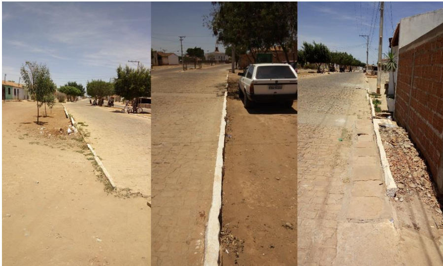
Figura 4-173 – Ausência de dispositivos de microdrenagem - Belo Campo
