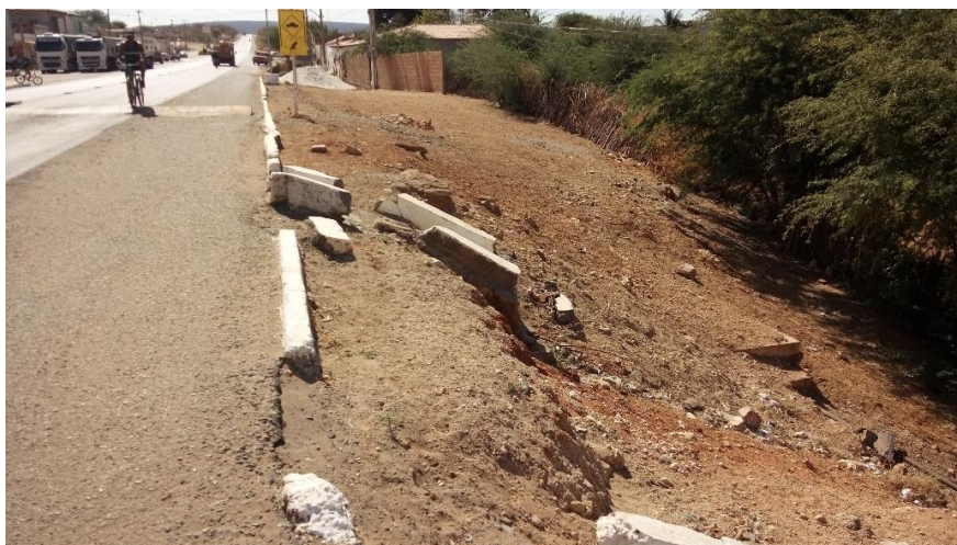
Figura 4-175 – Deterioração da rampa para escoamento das águas superficiais na rodovia BA-052 - Sede
