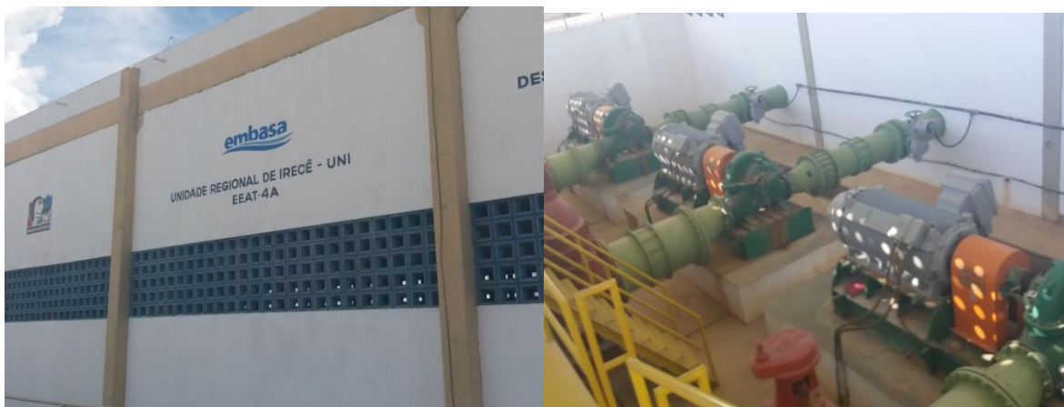
Figura 4-32 – Estação Elevatória de Água Tratada 4A e conjuntos moto-bomba
