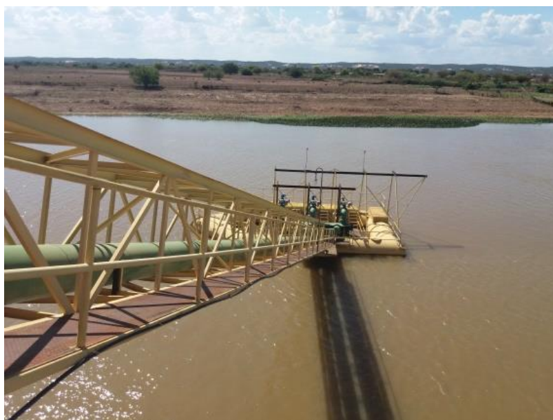
Figura 4-19 – Balsa flutuante da captação no Rio São Francisco.
