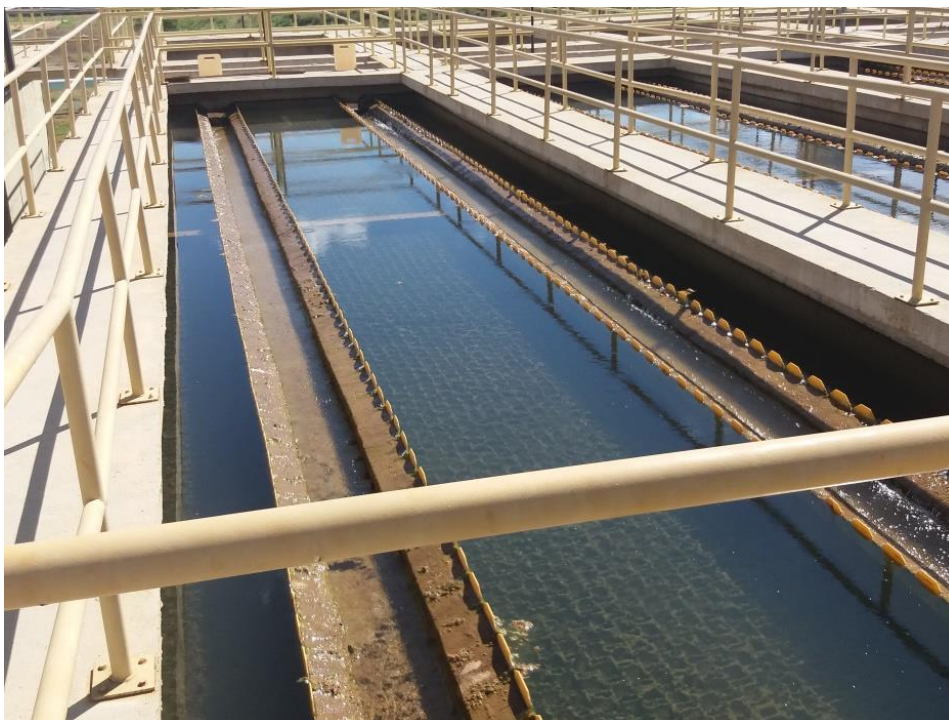
Figura 4-25 – Decantador na ETA Rio Verde Fonte: Projeta Engenharia (2017)
