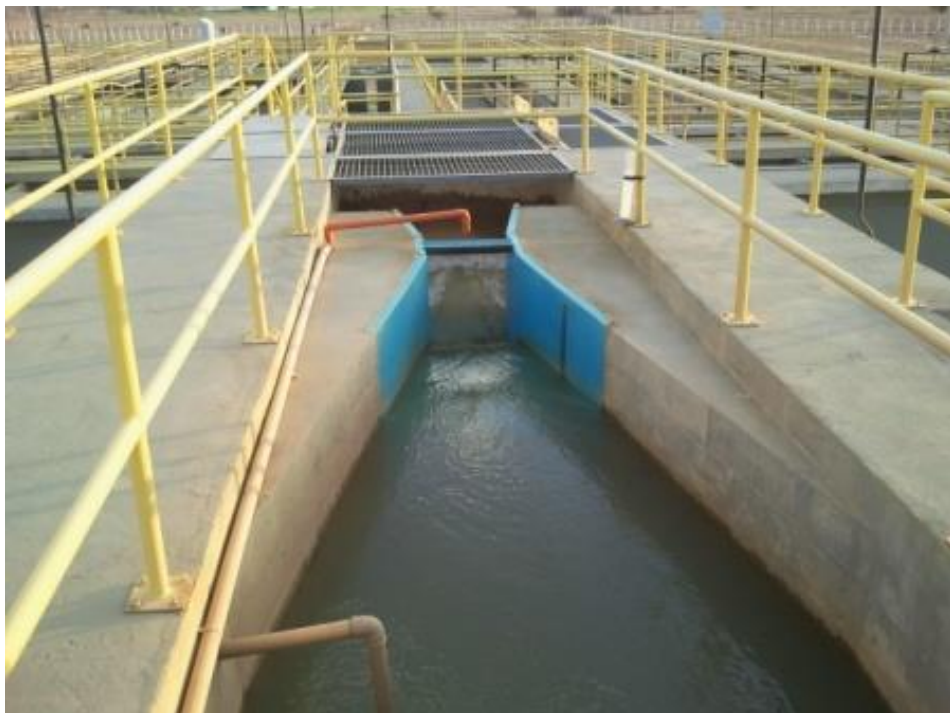
Figura 4-17 – Entrada de água bruta
