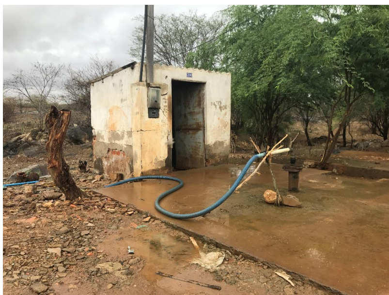
Figura 4-54 – Poço artesiano – Soares
