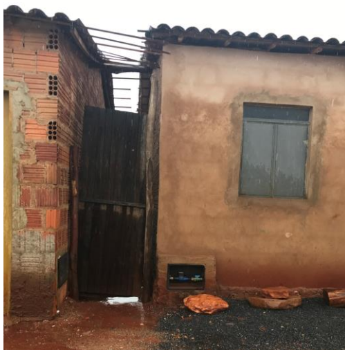
Figura 4-46 – Residência com rede água hidrometrada– Nova América
