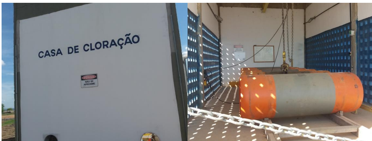
Figura 4-30 – Tinas de cloro destinado ao reservatório da Casa de Cloração-ETA Rio Verde
