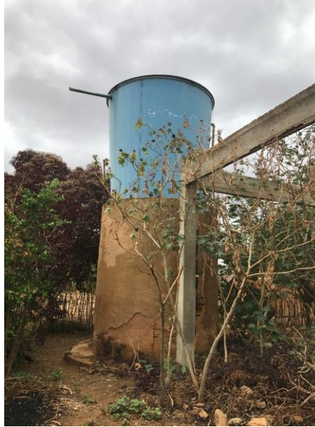
Figura 4-79 – Reservatório I de água salobra – Campo Alegre
