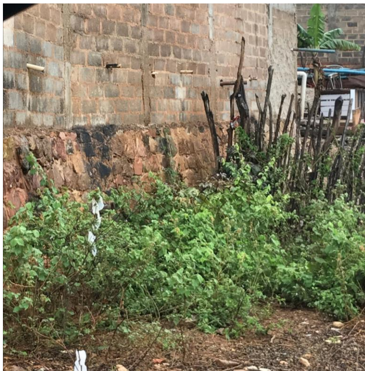
Figura 4-83 – Lançamento de esgoto na calha do Rio Jacaré
