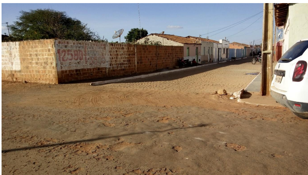
Figura 4-157 - Tipo de pavimentação no município de América Dourada: Asfalto (destaque para as condições do asfalto)
