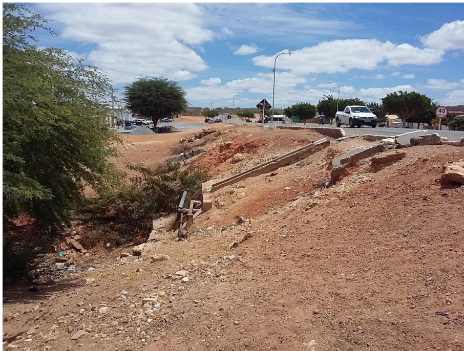
Figura 4-168 – Rampas para escoamento das águas superficiais na rodovia BA-052 – Lançamento no curso d’água intermitente (sem nome) - Sede Fonte: Projeta Engenharia (2017)
