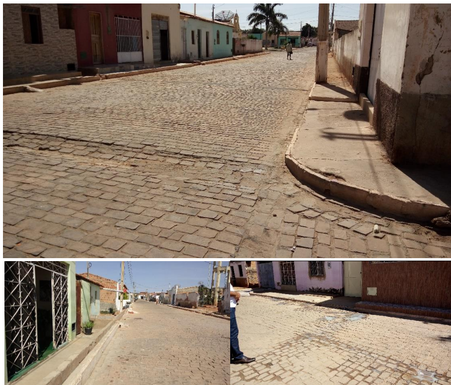
Figura 4-186 – Ponto 7 – Rua das Neves (Bairro Nova América) - Sede Fonte: Projeta Engenharia (2017)
