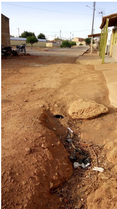
Figura 4-176 – Entupimento de galeria de pequeno porte com terra, dispositivo para condução das águas pluviais a uma bacia de captação - Rua da Matriz - Soares
