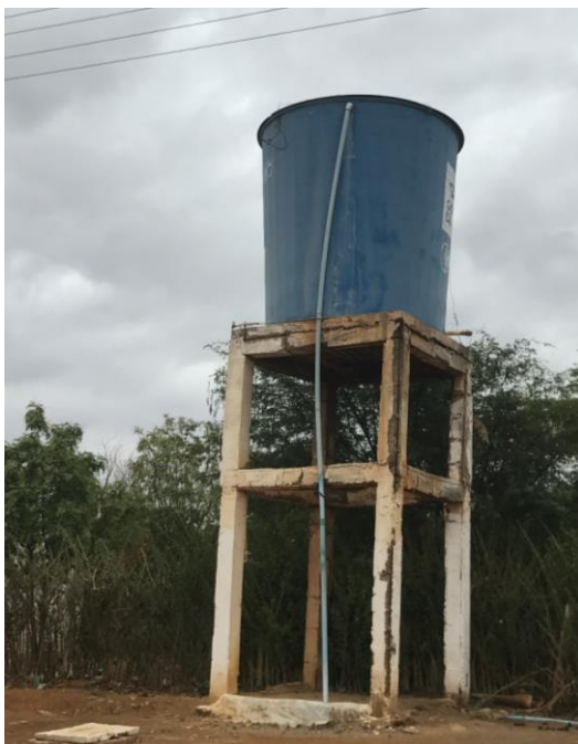
Figura 4-77 – Reservatório de salobra - Boa Vista
